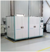
中國常州的廢水處理機器
